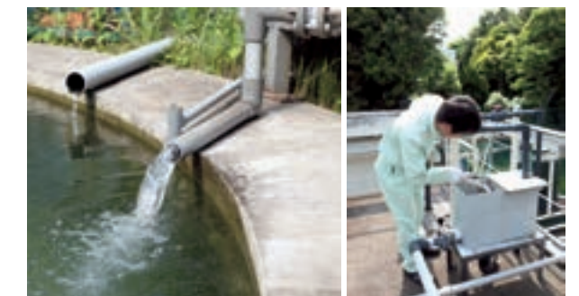
放流池 排水処理設備の点検
